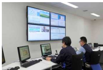
365日24時間体制の運用監視ルーム
