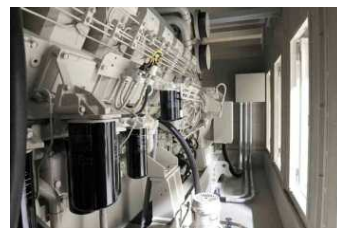
72時間連続稼働OKの自家発電装置
