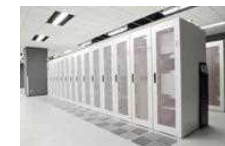
セキュリティと空調効率、災害対策に配慮したサーバラックフロア
