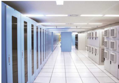
サーバーラック(浦和センター)
