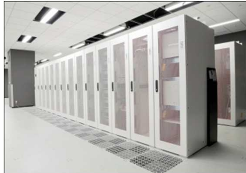
サーバーラック(さいたまセンター)
