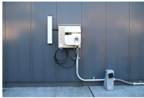
AGSビルの給電口
